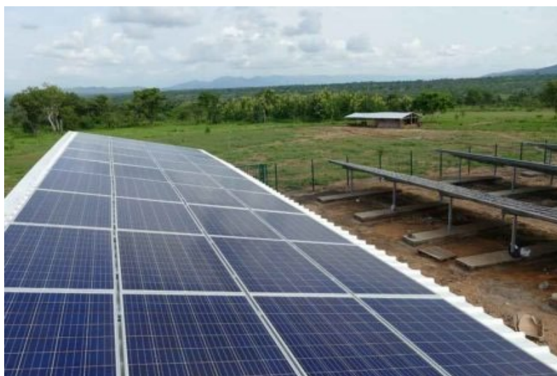
Centrale au sol, Ruitz (59)
